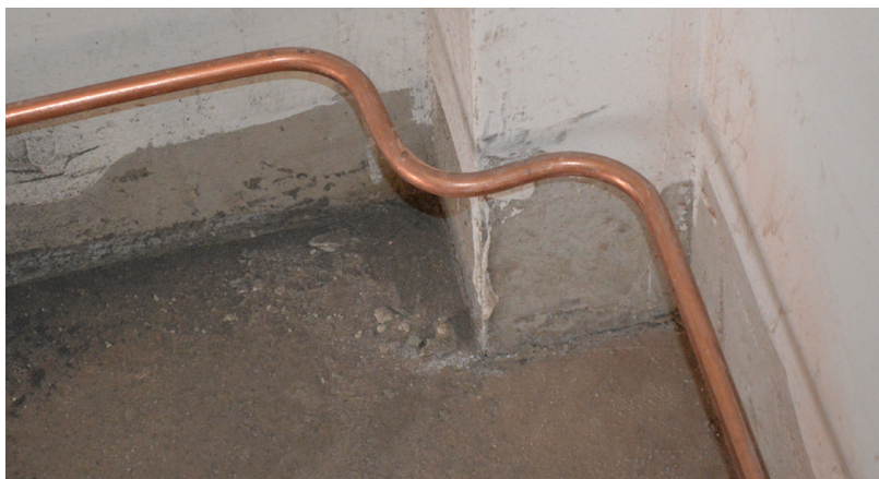
Equipotential grounding conductor
